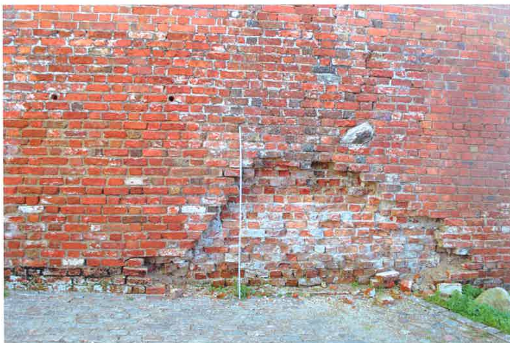
Rys. 3 widok zniszczonego lica muru kurtynowego i styku nawierzchni brukowej
