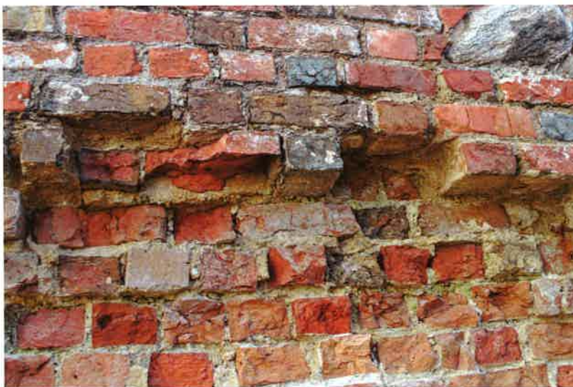
Rys. 11 górna krawędź uszkodzonego lica z widocznymi warstwami przewiązanego lica i muru gotyckiego, poniżej wnętrze muru z widocznymi uszkodzonymi obecnie i wcześniej ceglami wiązania.
